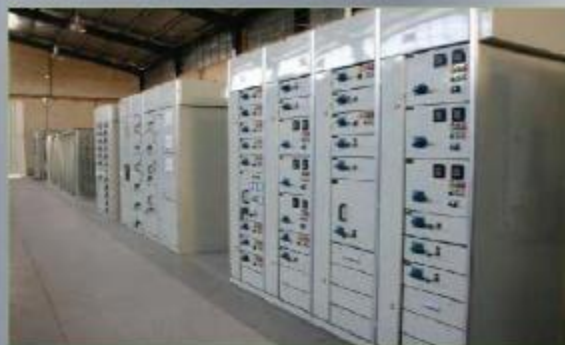
تابلوهای فشار ضعیف فیکس و کشویی
